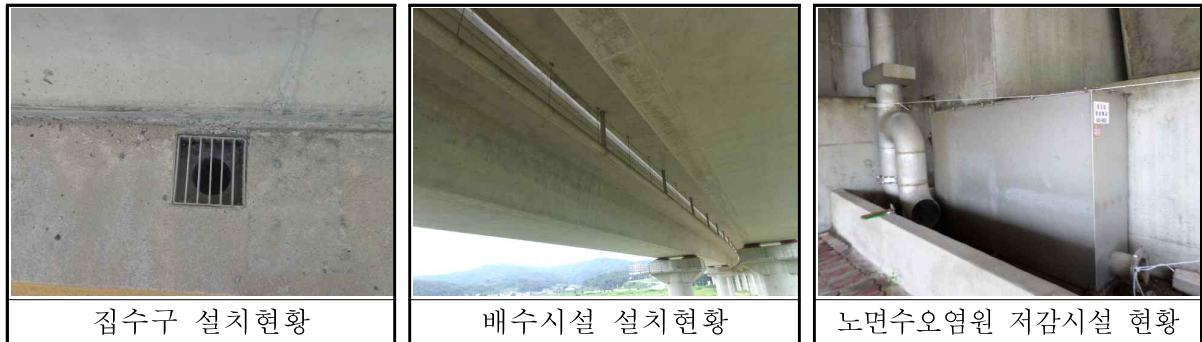
【그림 3.26】 배수시설 현황
