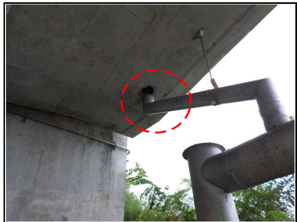
배수관 탈락(S1: 양천방향)
