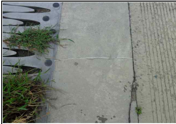
cw=0.3mm미만 후타재 균열(Exp.1:양천방향)
