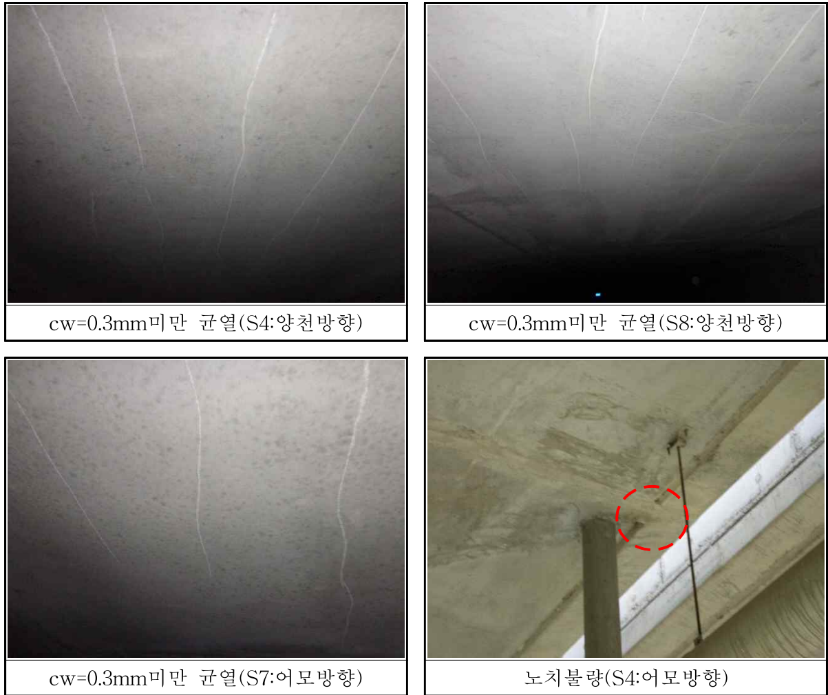
【그림 3.11】 바닥판하면 손상 현황
