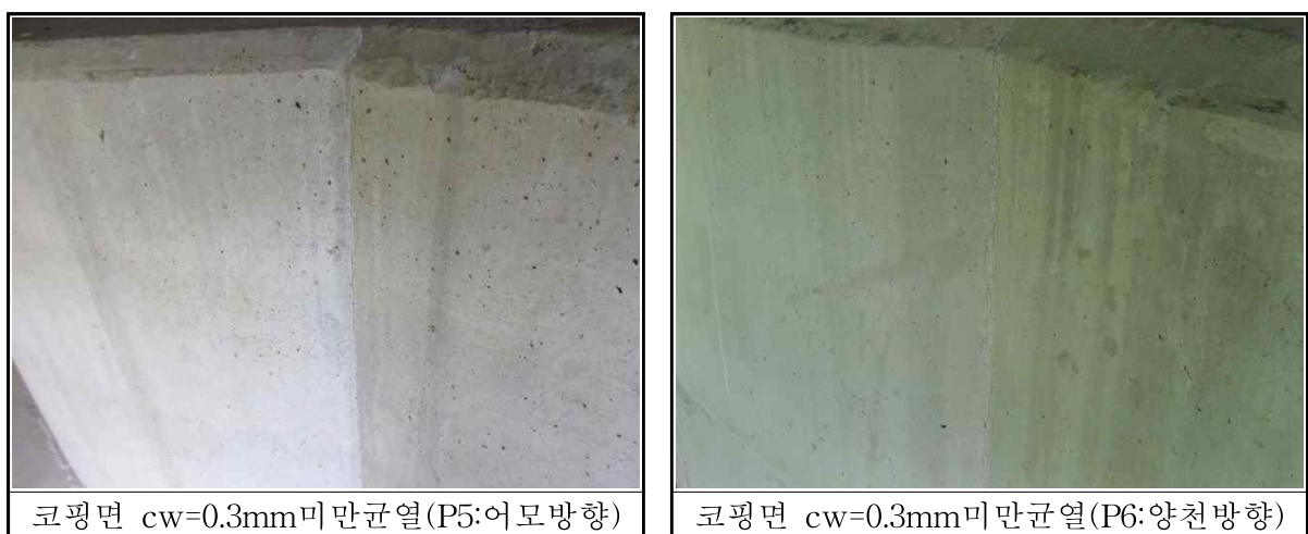
【그림 3.19】 교각 손상 현황
