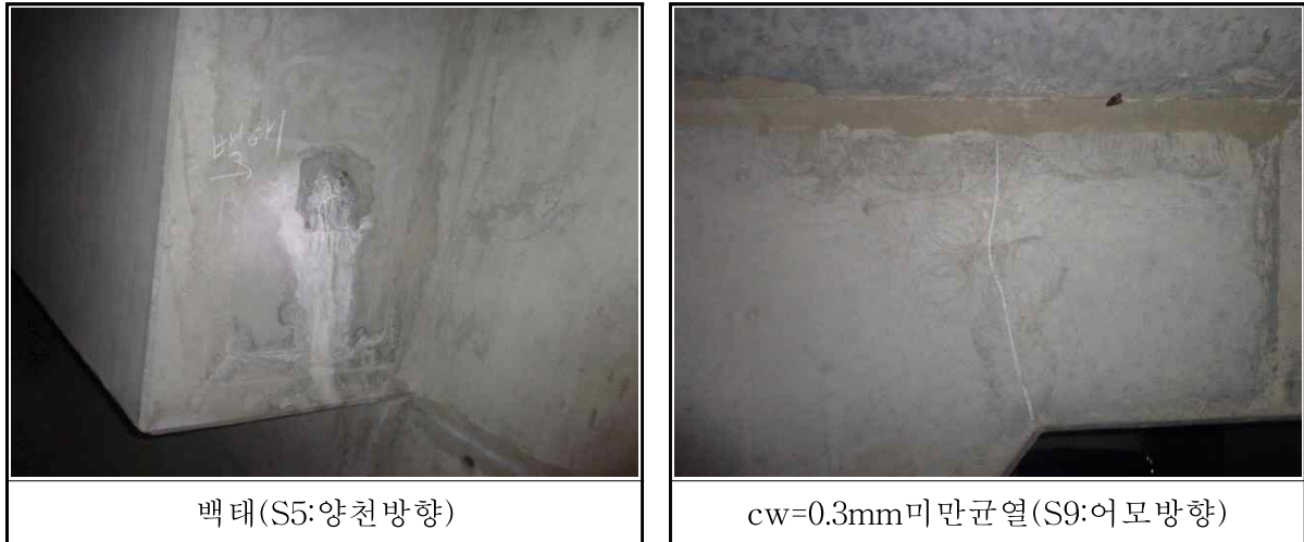
【그림 3.14】 P.S.C Box Girder내부 손상 현황
