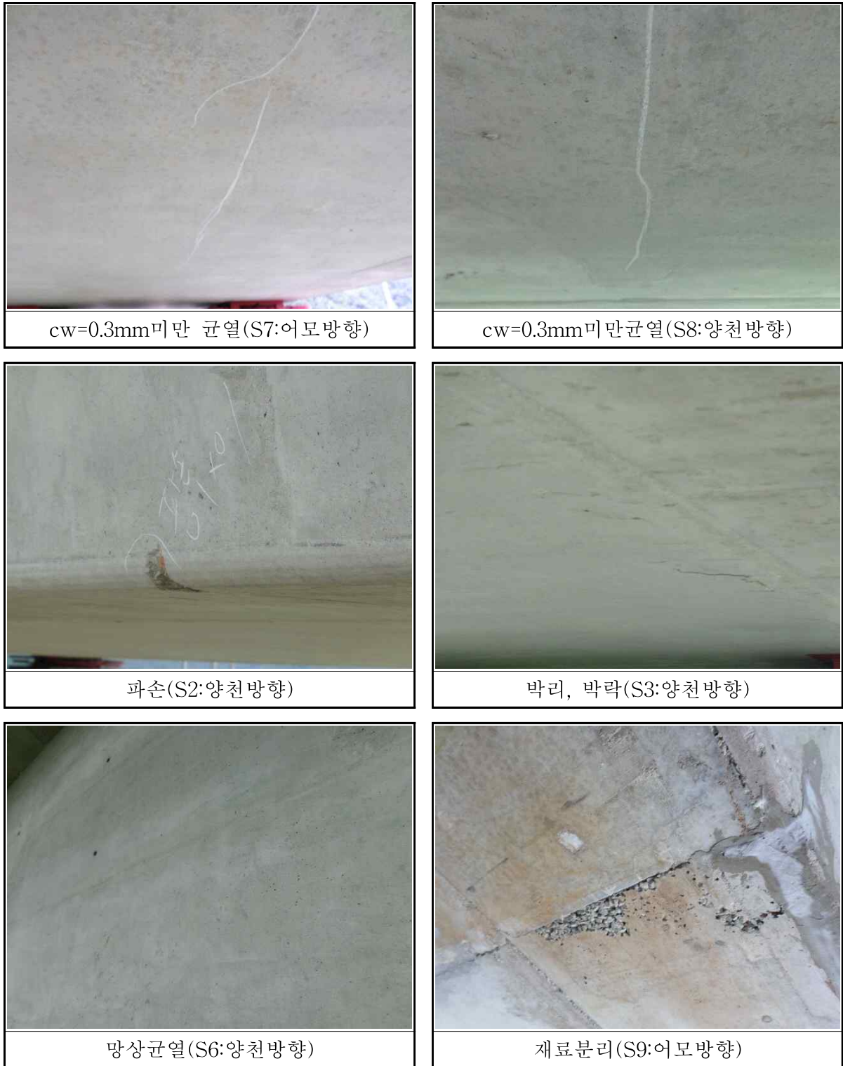
【그림 3.13】 P.S.C Box Girder외부 손상 현황
